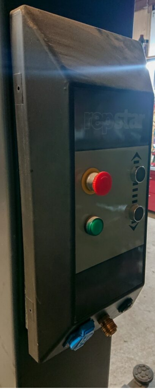
Hebebühnensteuerung (mit 230 VAC und 12 VDC Versorgung).
